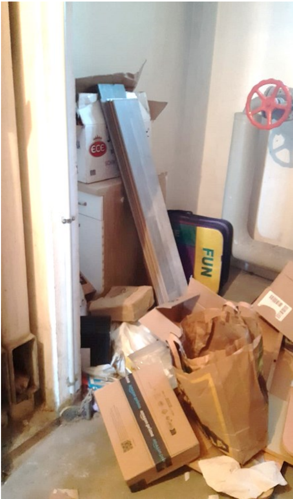
Der Keller als Altpapierdeponie - wegen der Brandschutzbestimmung eigentlich verboten!
